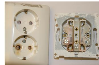
Fig 5 – Skade / varmgang kontakt ved manglende avlastning
